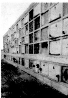
DEGRADO Lavori non terminati
